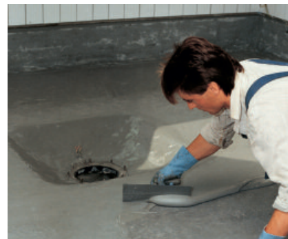
Auftragen von PCI Apoflex F zum Abdichten unter dem Keramikbelag einer Großküche.
