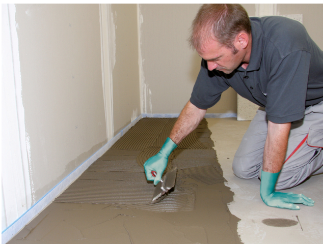
Nach Trocknung der Spachtelmasse wird auf den planebenen Untergrund z. B. Sopro's No. 1 Flexkleber aufgetragen.
