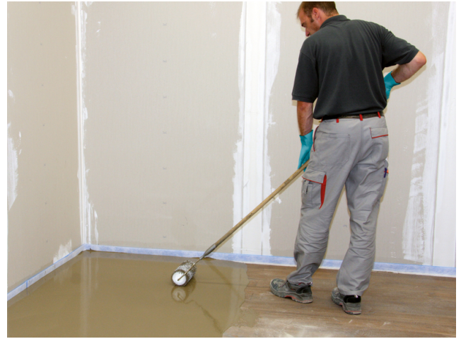
Mit einer Stachelwalze wird die aufgebraute Spachtelmasse verteilt und verdichtet, um eine planebene Oberfläche zu erhalten.
