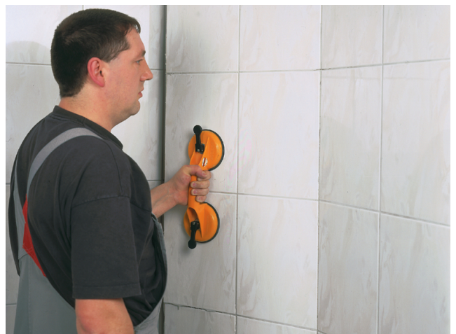
Nach Entfernen der Sanitäröbekte und dem Aufscheiden der Silikonfugen wird der Fliesenbelag mittels eines Sauggriffes aufgenommen.
