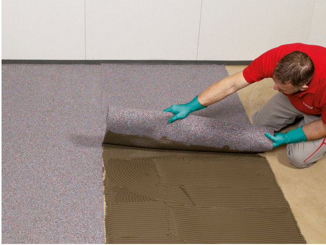
Die nachfolgende Bahn dicht anlegen und stoßen. Dabei darauf achten, dass kein Verlegemörtel durch den Stoßbereich austritt.
